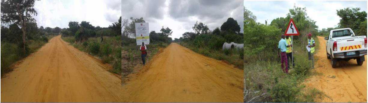
As imagens mostram as obras de melhoria da drenagem para águas pluviais, trabalhos de abaulamento da plataforma e colocação de sinais rodoviárias
